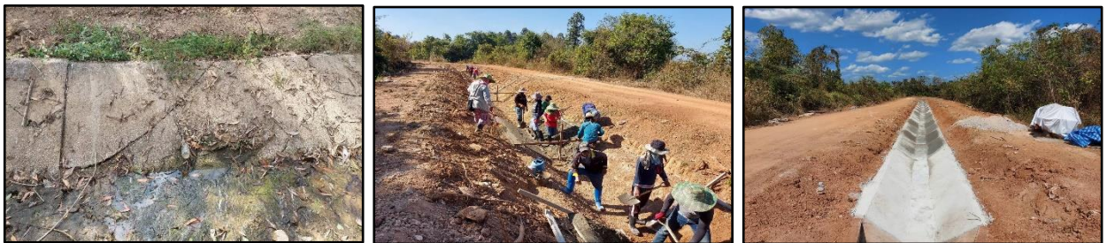
ซ่อมแซมคอนกรีตตาดคลอง คลองแยกซอย ๑L-๑R, ๒L-๑R RMC จังหวัดลำปาง
