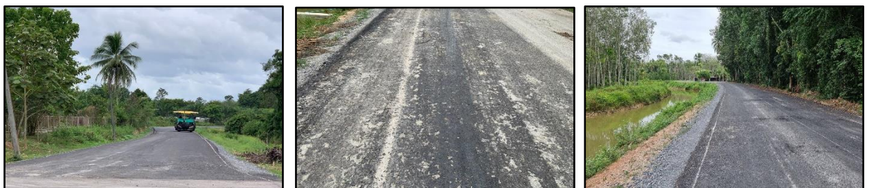
งานปรับปรุงถนนบนคันคลองส่งน้ำ LMC (ควนกุฎิ) จังหวัดพัทลุง
