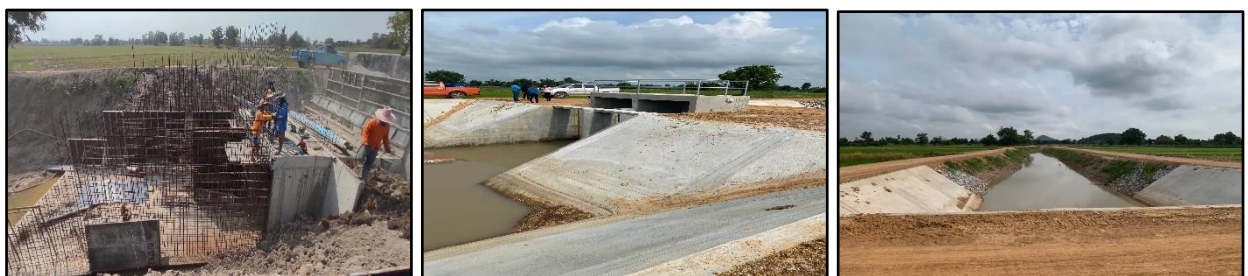
ระบบระบายน้ำหนองยาว จังหวัดนครสวรรค์
