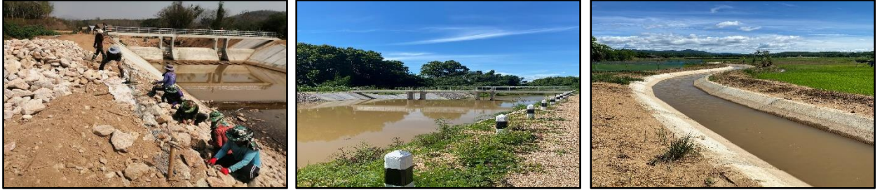
ฝายเหมืองบน พร้อมระบบส่งน้ำ จังหวัดลำปาง
