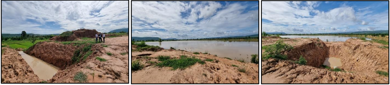
ซ่อมแซมอาคารรับน้ำลำลำลาย จังหวัดนครราชสีมา
