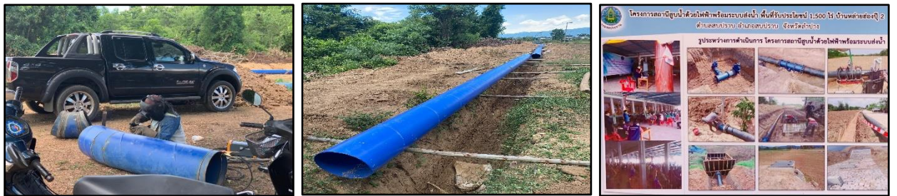
สถานีสูบน้ำด้วยไฟฟ้าพร้อมระบบส่งน้ำ บ้านหลายฮ่องปู่ จังหวัดลำปาง
