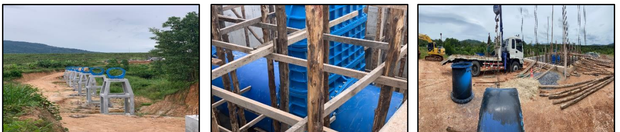
ระบบส่งน้ำพร้อมอาคารประกอบ (อ่างเก็บน้ำคลองดินแดง) จังหวัดนครศรีธรรมราช
